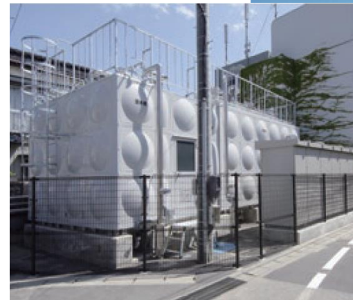
集中給湯設備
