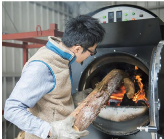
温泉施設の薪ボイラー
